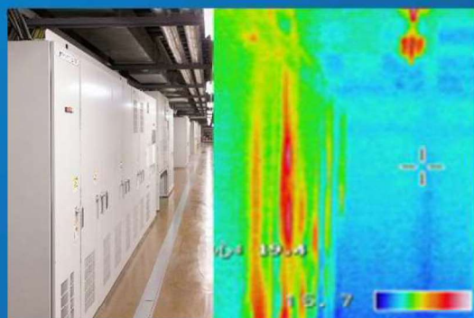
データサーバの温度管理
