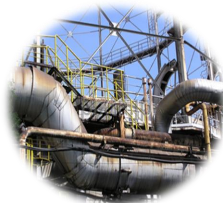
プラント設備
