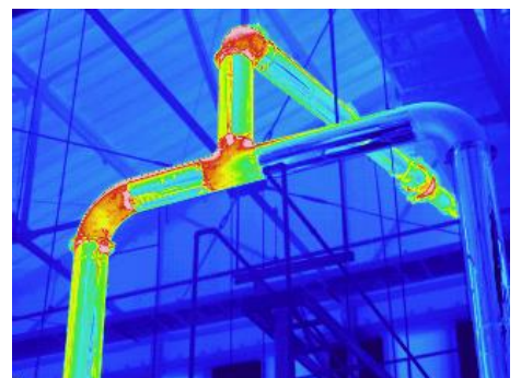
配管の断熱材劣化
