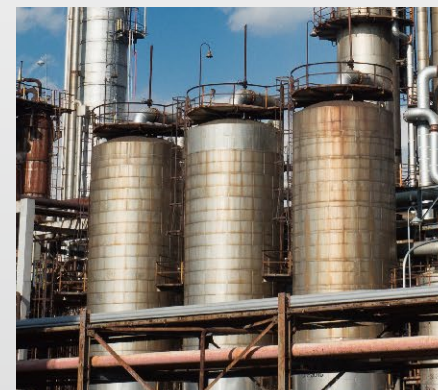
プラント設備
