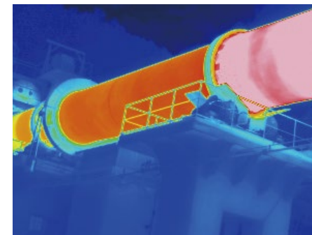
炉壁の耐熱材の減厚状態
