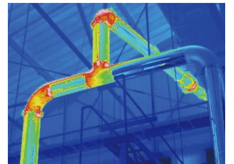
配管の断熱材劣化
